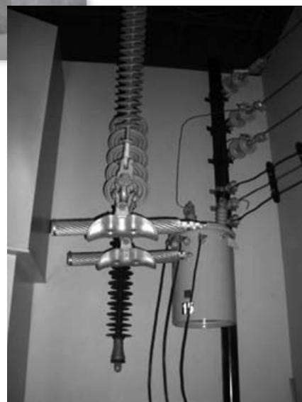
写真④ 送電設備や配電設備の実寸モデル
